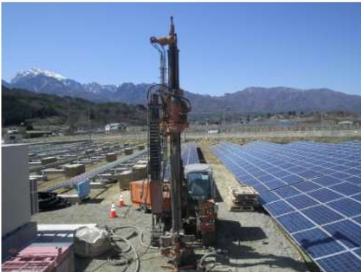
▲メガソーラー発電所での ロータリーパイプレーションマシンを用いた施工状況
