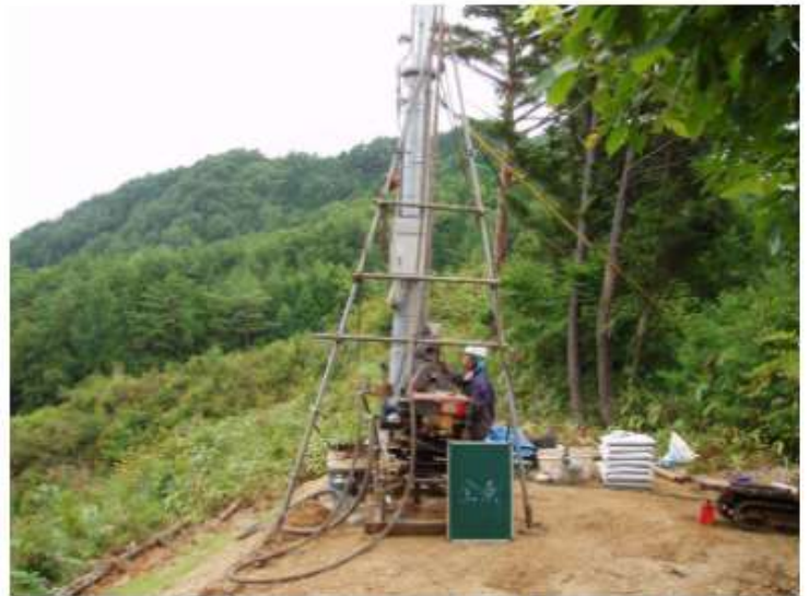
▲携帯電話基地局でのロータリーマシンを用いた施工状況
