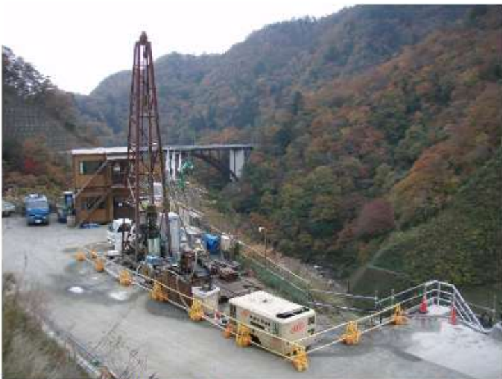
▲ダム管理棟におけるロータリーマシンを用いた施工状況
