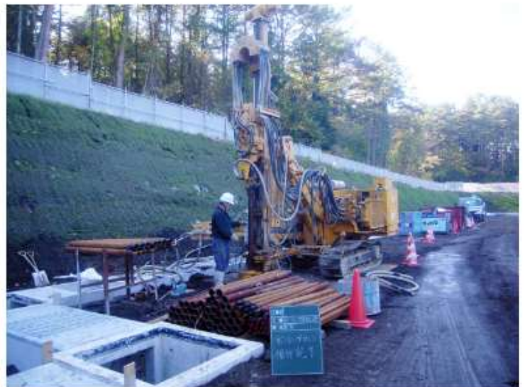
▲工場受変電設備での ロータリーパーカッションマシンを用いた施工状況
